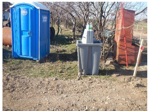
Sisteme modulare: toaletă individuală, chiuvetă modulară; pichet PSI
