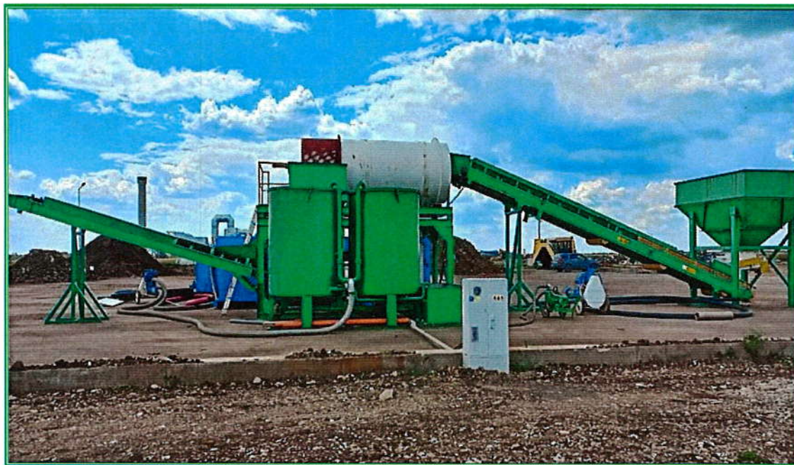
Instalatie spalare soluri contaminate
