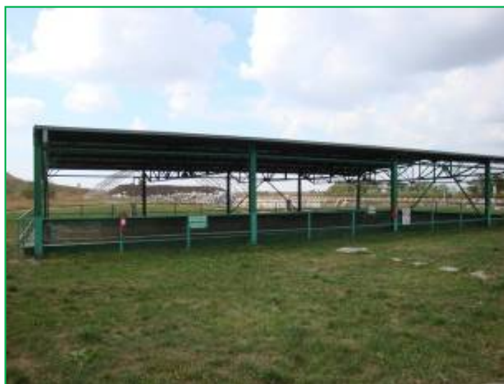
Bazinul decantor, acoperit
