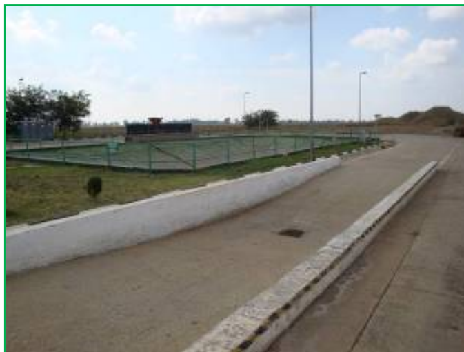
Rampa de spalare roti si bazinul de ape pluviale
