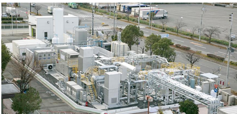
Figura 6.12 - Centrală de cogenerare urbană alimentată 100% cu hidrogen
