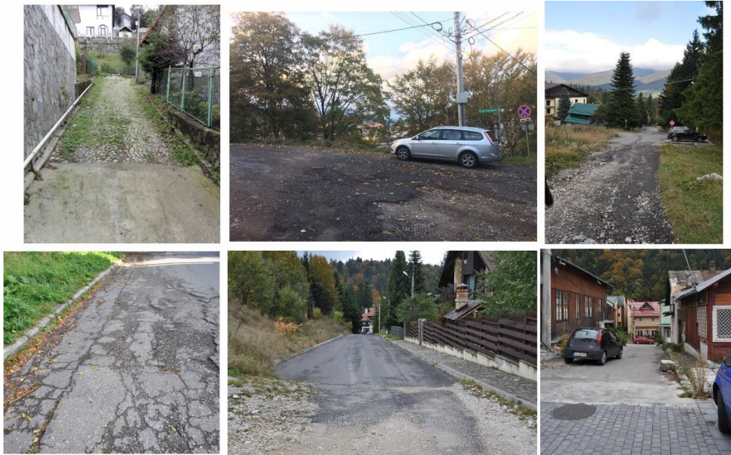
Figura 2-15- Exemple de străzi într-o stare avansată de degradare
