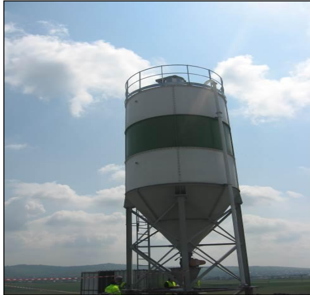
Fig. 5: Instalatie tratare/stabilizare cenusa
