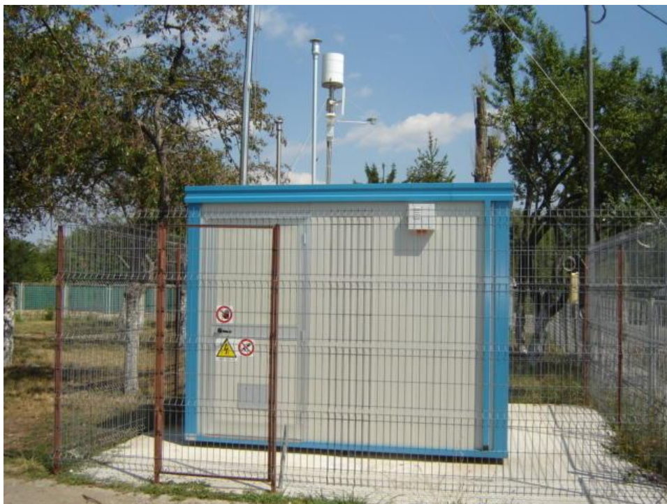
Fig. nr.6. Stație de monitorizare automată a calității aerului
