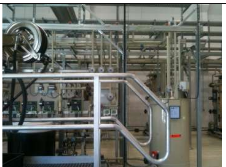
Tratarea apei de răcire – rezervor apă brută
