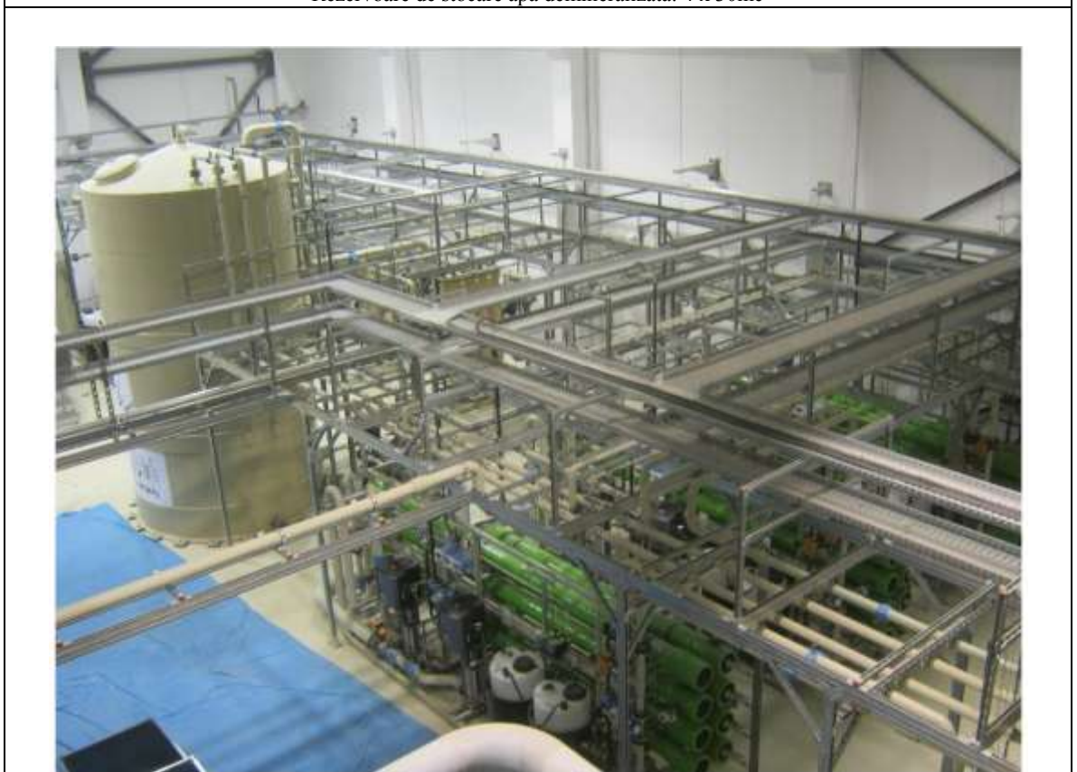
Clădire Instalație de producere apă demineralizată
